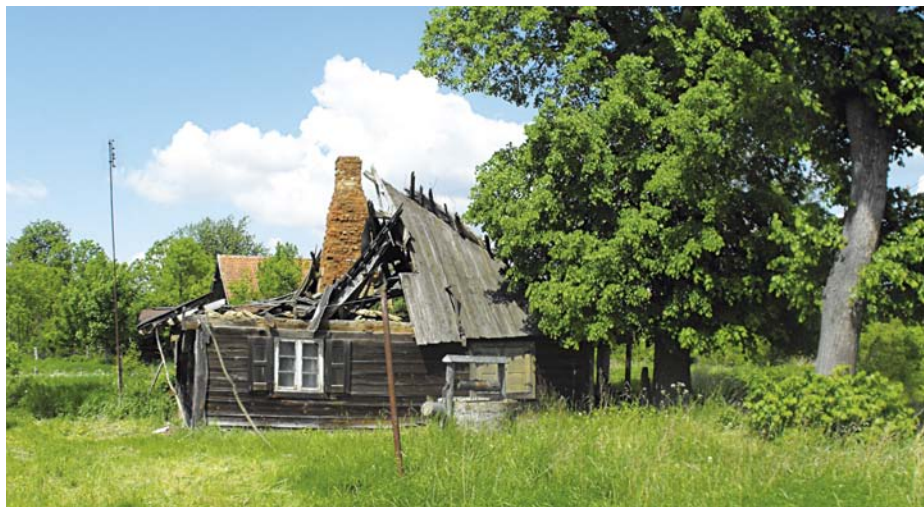
Il. 17. Ruiny chałupy podcieniowej nr 11, w Krośnie, gm. Pasłęk, stan z 2010 r. fot. Archiwum MBL-PE w Olsztynku.
