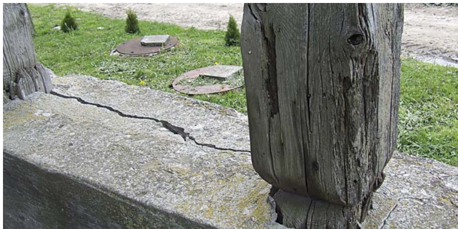
Il. 16. Chałupa podcieniowa nr 43, we wsi Kalnik, gm. Morąg, niewłaściwa konserwacja cokołu, stan z 2010 r. fot. Archiwum MBL-PE w Olsztynku.
