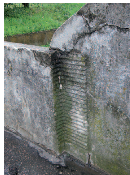
Il. 20. Ryflowane wykończenie na styku balustrady w miejscu usytuowania kapliczki środkowej. Widoczne dodane wtórne zakończenia parapetu balustrady, fot. W. Chodkowska 2016.
