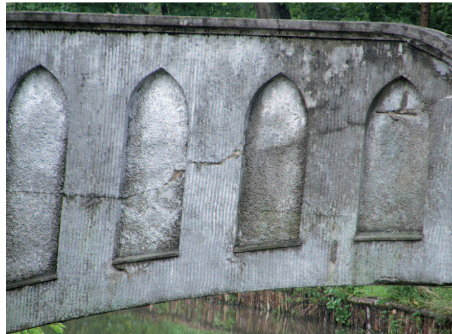
Il. 22. Widok na most/kładkę im. Mikołaja Kopernika od strony zachodniej, pęknięcie balustrady w miejscu środkowej kapliczki, fot. W. Chodkowska 2016.
